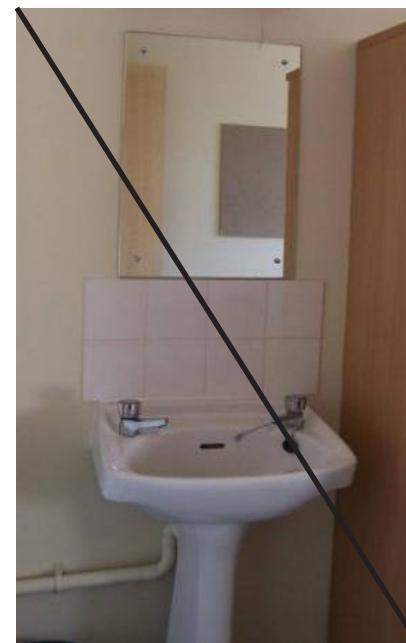
Плохо Раковина с пьедесталом. Фартук из плитки
